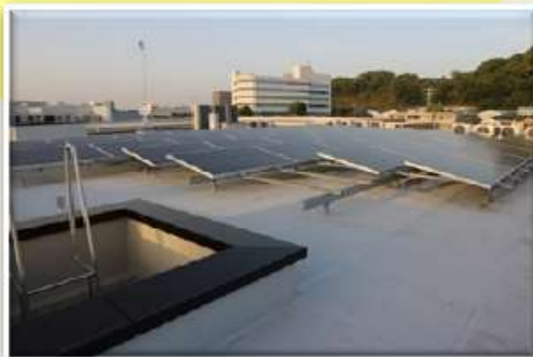
へいあん片瀬鵜沼 太陽光発電設備
