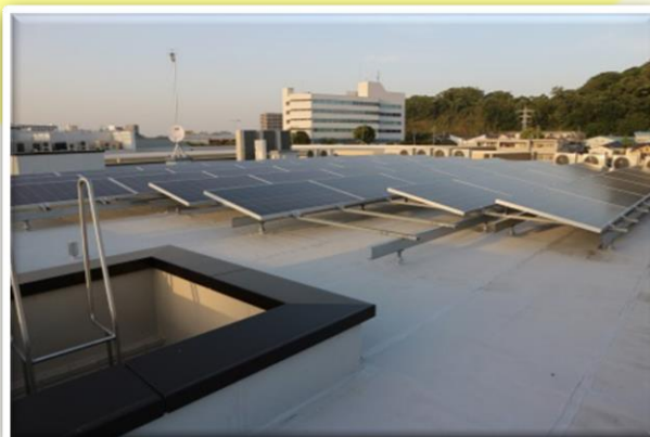
へいあん片瀬鵜沼 太陽光発電設備
