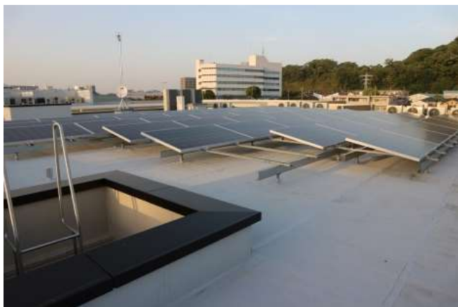
へいあん片瀬鵜沼 太陽光発電設備
