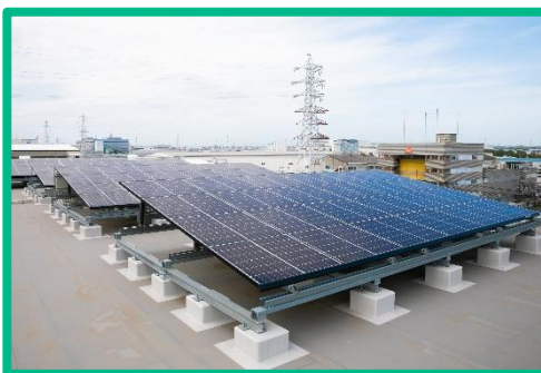
山大商事新社屋太陽光発電設備
