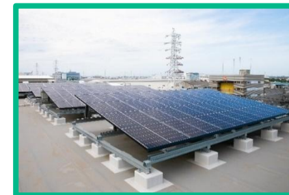
山大商事新社屋太陽光発電設備
